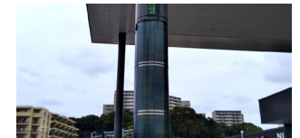
キャンピー柱に設置した 太陽電池
