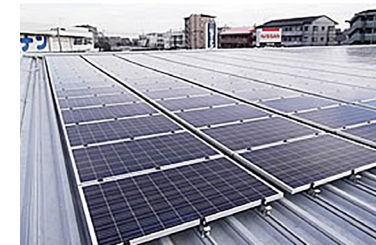
神奈川日産自動車(株)の一部の販売店の屋根に設置した太陽光パネル。得られた電力を日産がPPSとして調達し販売店に供給しています
