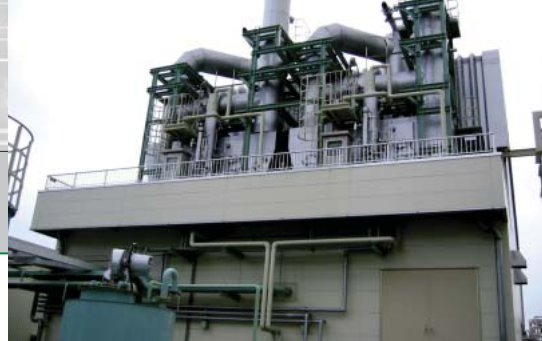
発電で生じる廃熱を有効利用するコ・ジェネレーションシステムを導入（日本）
