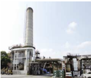
構内焼却炉(栃木工場)
